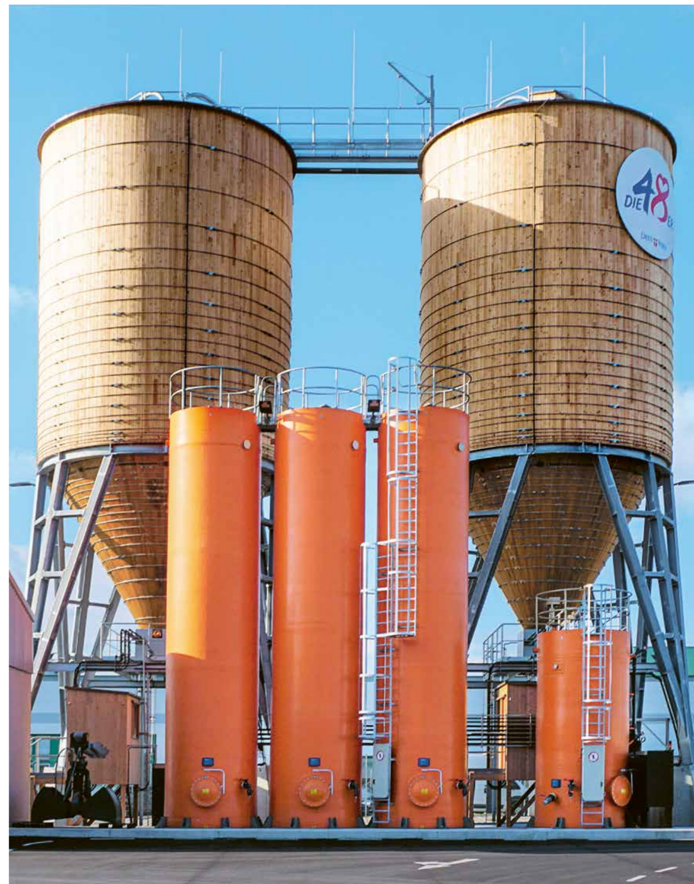
Wien (AT), 2 × 500 m 3 , okrogel silos in 3 × 45 m 3 , rezervoarji za skladiščenje slanice s pripravo slanice.
