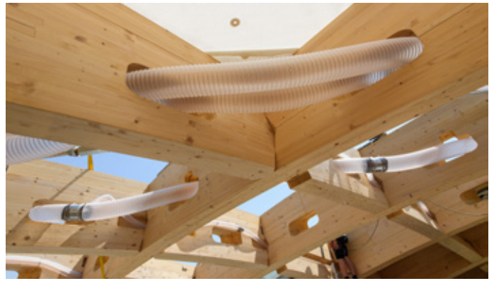
Die Leitungen für die Haustechnik sind direkt im Holzbau integriert.
